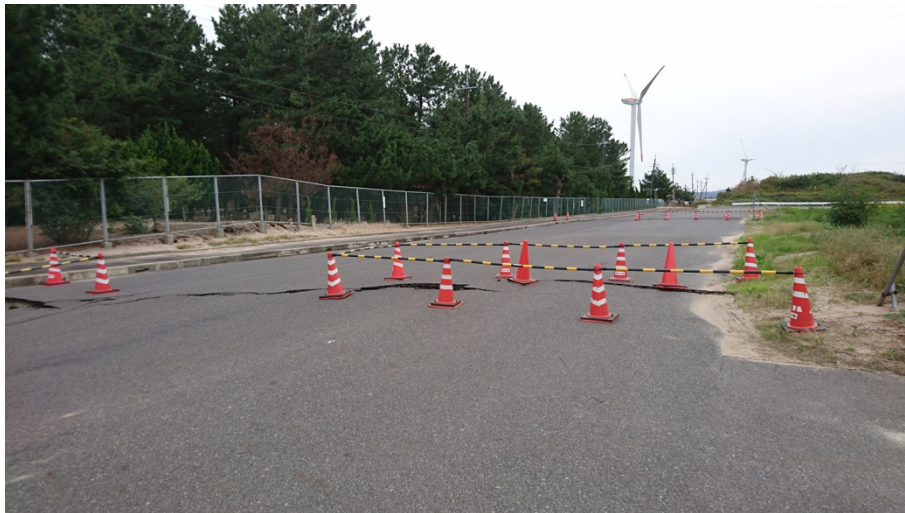
写真7 北条オートキャンプ場駐車場の地盤変状（北栄町）
