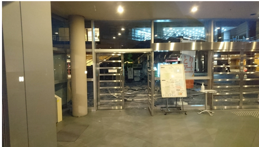
写真5 吊り天井の落下（倉吉未来中心）
