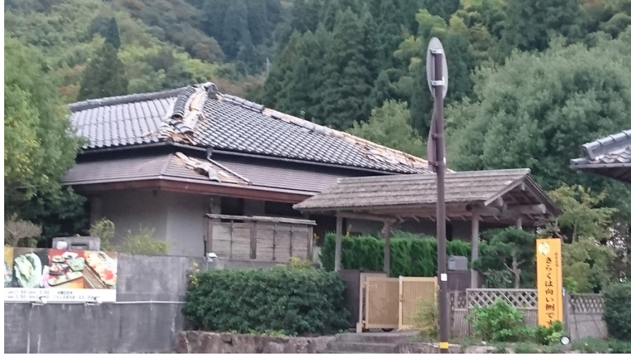
写真3 瓦屋根の被害（三朝町）
