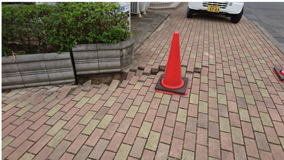
写真8 北条オートキャンプ場駐車場の地盤変状（北栄町）
