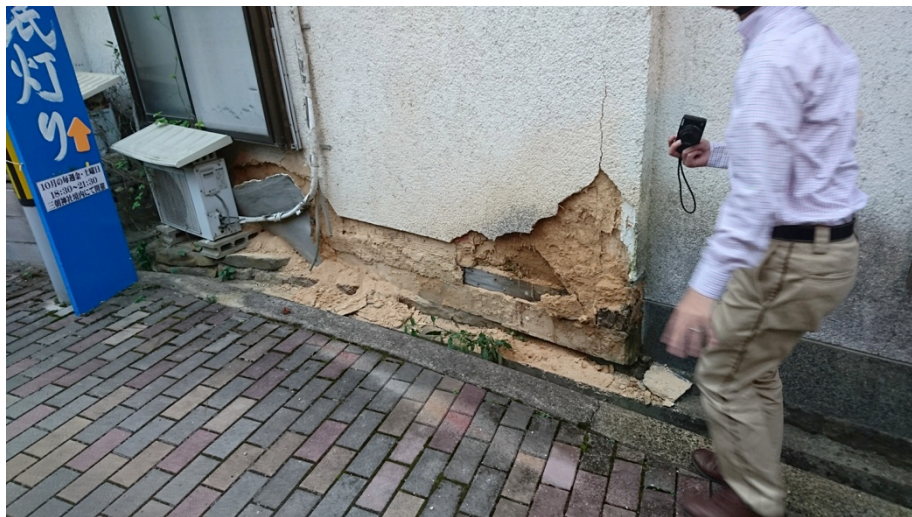
写真4 外壁の被害（三朝町）
